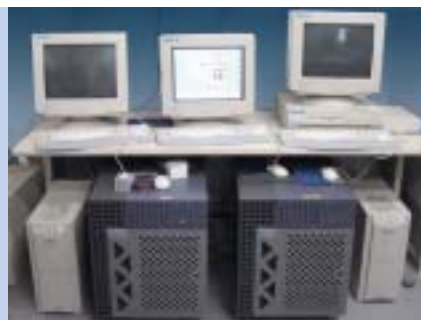
メールサーバ及びデータベースフロントエンドサーバ
